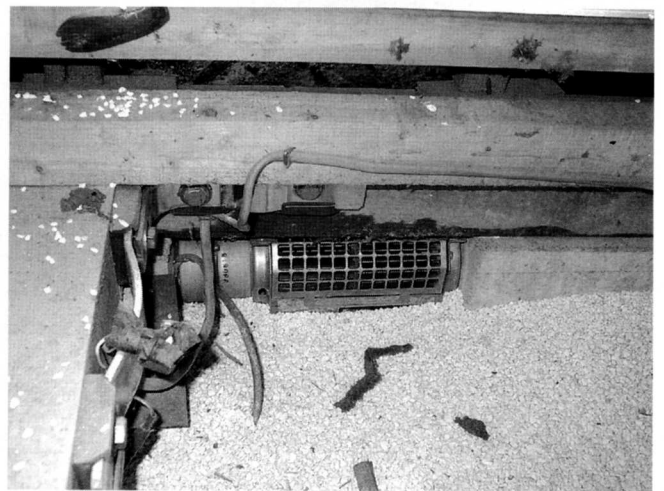
写真2 調湿材・床下換気扇・耐震金物、悪質点検商法の3点セット（問題事案の一例）
